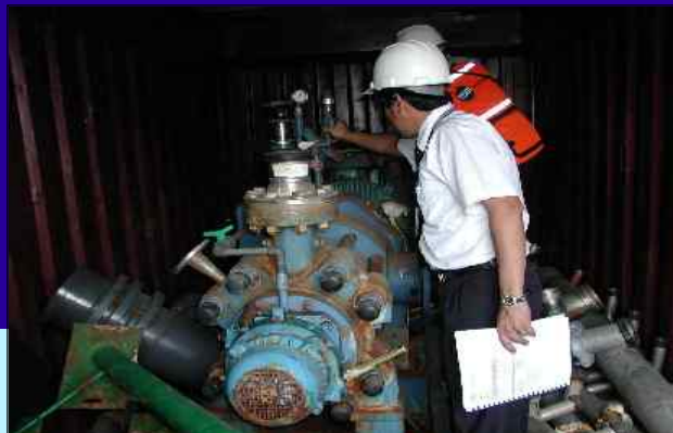
Representantes de Sedapal inspeccionan los almacenes donde se encuentran los componentes de la Planta desalinizadora.
