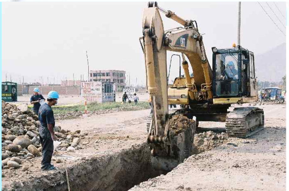
Los trabajos en Carabayllo se iniciaron con el tendido de la línea de 8 km para el Colector Torre Blanca, en Punchauca.
