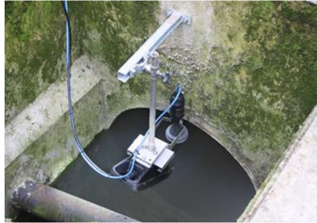
Tuberías Parcialmente Llenas
